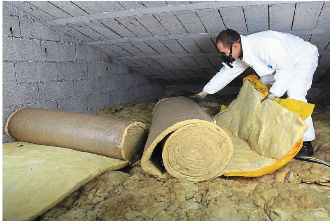
Les offres d'isolation à 1 € donnent parfois lieu à des travaux bâclés, réalisés avec des matériaux bon marché, voire inadaptés.
